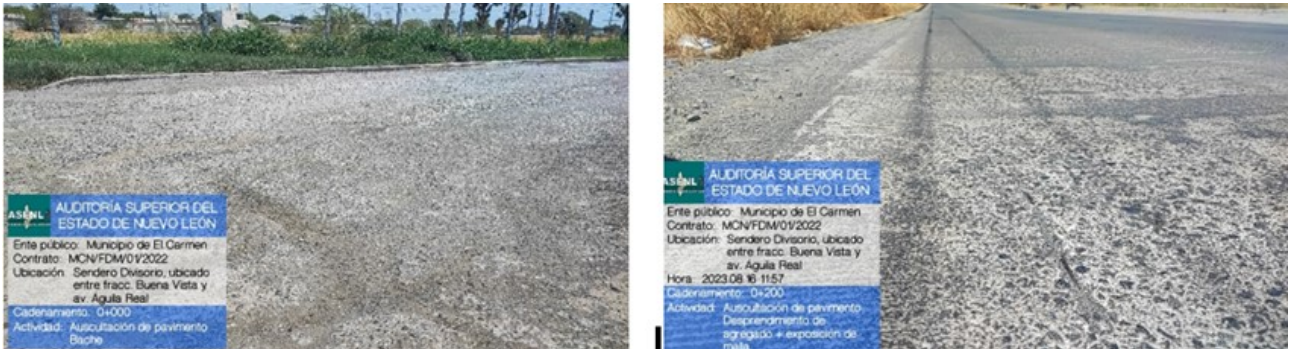
Imagen izquierda, falla número 1, Bache, cadenamiento 0+000; Imagen derecha, falla número 6, Desprendimiento de agregados y exposición de malla de refuerzo, cadenamiento 0+200.
