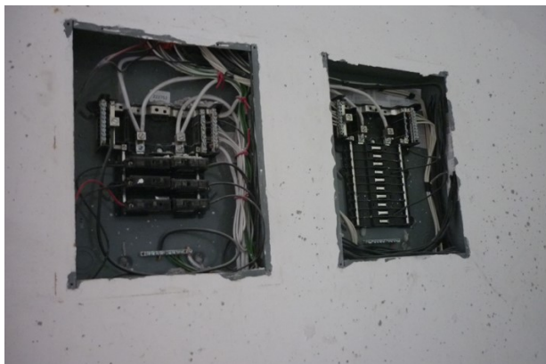
Centro de carga sin sus cubiertas.
